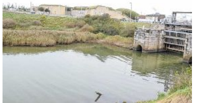
Des travaux pourraient être nécessaires sur les quais du bassin des Chasses pour éviter les submersions marines et le risque d'inondations à Calais.
